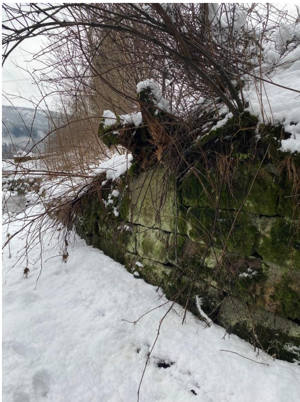
Figur 4-17 Plassering av flomkulvert ca. 15 meter oppstrøms jernbanekulvert, der tørrmuren reduseres i høyde fra ca. 5 meter og ned til 2-3 lag med stein.
